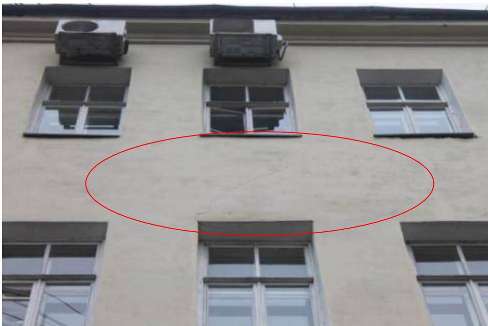
Рис.3.3. Трещины над перемычкой, фасад по оси "А".
