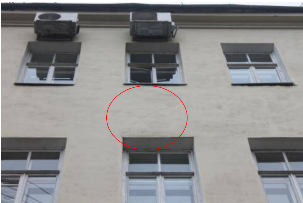
Фото 12. Трещины над перемычкой, фасад по оси "А".
