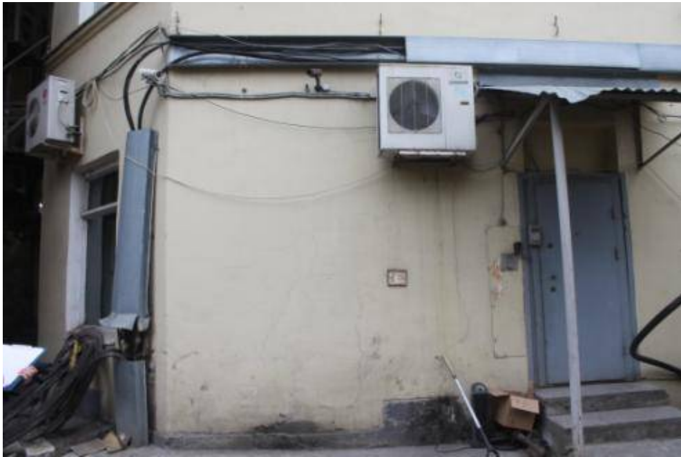
Фото 9. Система волосяных трещин, фасад по оси "А".
