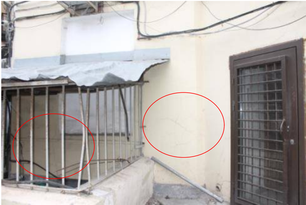
Фото 19. Система волосяных трещин в штукатурном слое, фасад по оси «Б».
