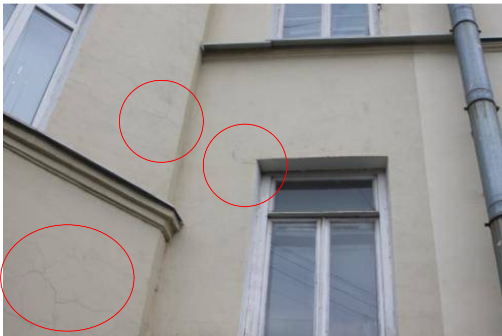
Фото 22. Система волосяных трещин в штукатурном слое, фасад по оси «Б».
