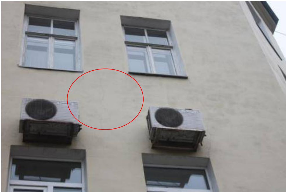
Фото 13. Система волосяных трещин в штукатурном слое , фасад по оси "А" .
