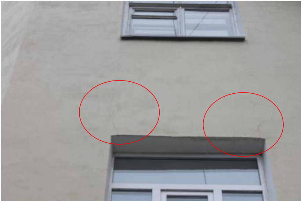
Фото 17. Трещины над перемычкой, фасад по оси «Б».
