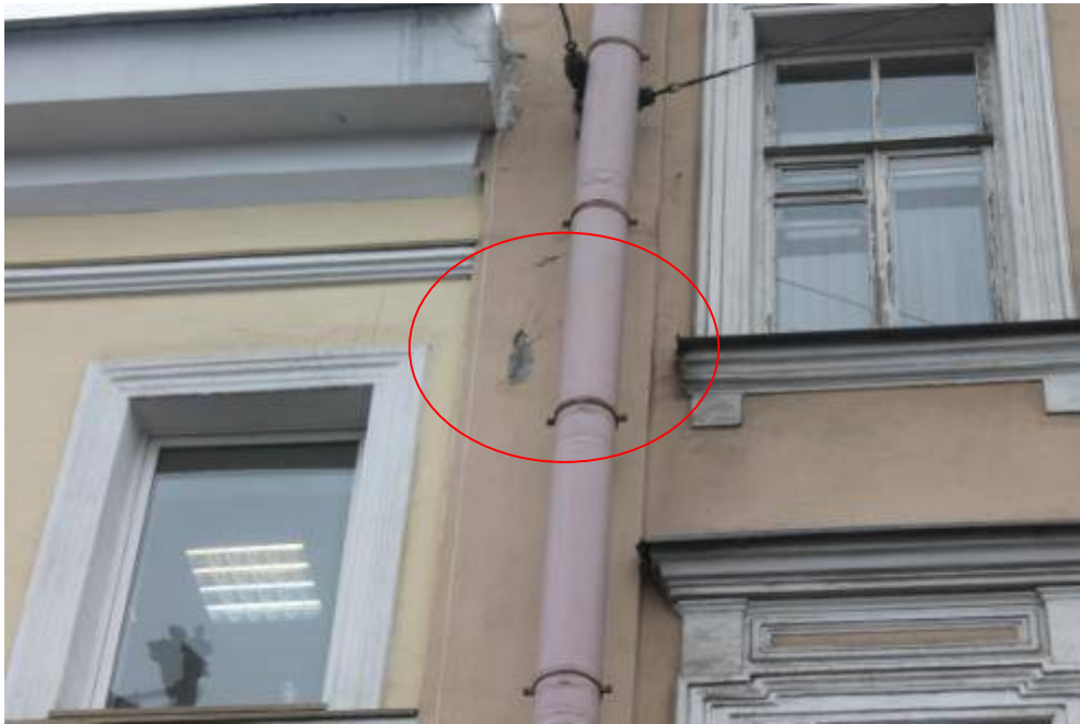
Фото 3. Отслаивание штукатурного слоя, фасад по оси «Е».
