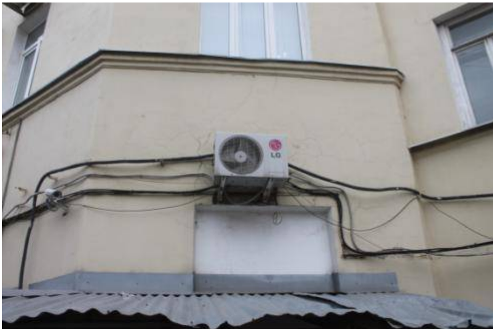
Фото 16. Система трещин над перемычкой фасад по оси «Б».
