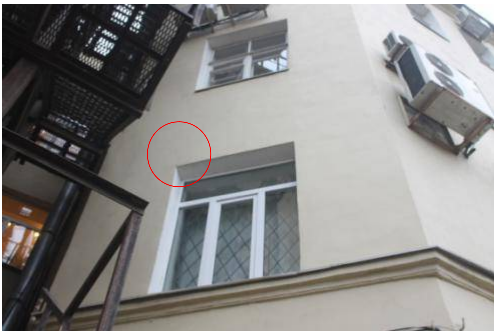
Фото 8. Волосьяные трещины над перемычкой, фасад по оси "А".
