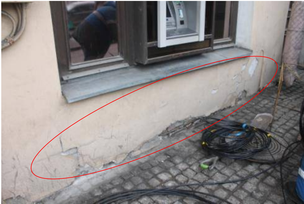
Фото 1. Деструкция штукатурки, фасад по оси «Е».
