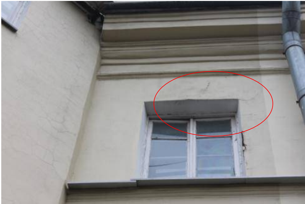
Фото 23. Система трещин над перемычкой, фасад по оси "А".
