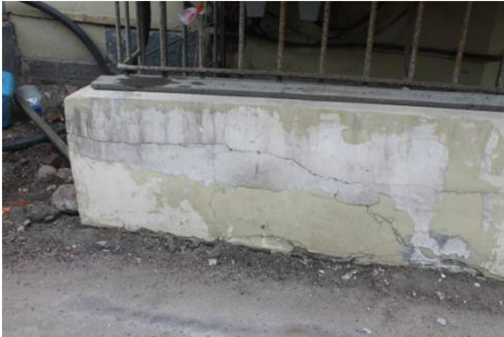
Фото 15. Отслоение штукатурки, трещина в бетонной конструкции входа в подвал, фасад по оси "А" .
