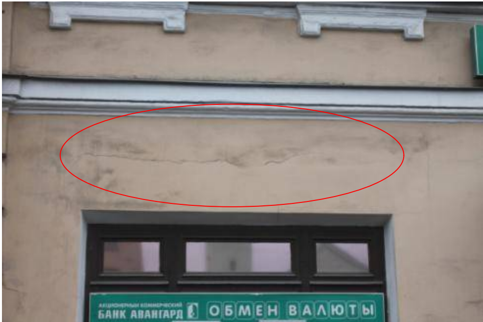
Рис. 3.4. Система волосяных трещин в штукатурном слое, фасад по оси «Е».
