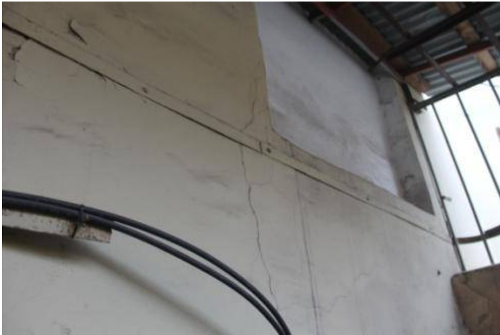
Фото 5. Система трещин над входом в подвал, фасад по оси "А".
