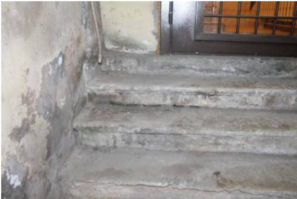
Фото 20. Деструкция ступеней из бутового камня, замачивание внешней фасадной системы по оси "А".
