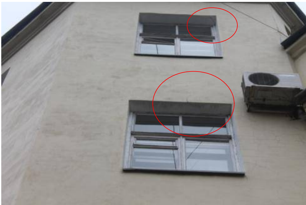
Фото 18. Трещина над перемычкой, фасад по оси «Б».
