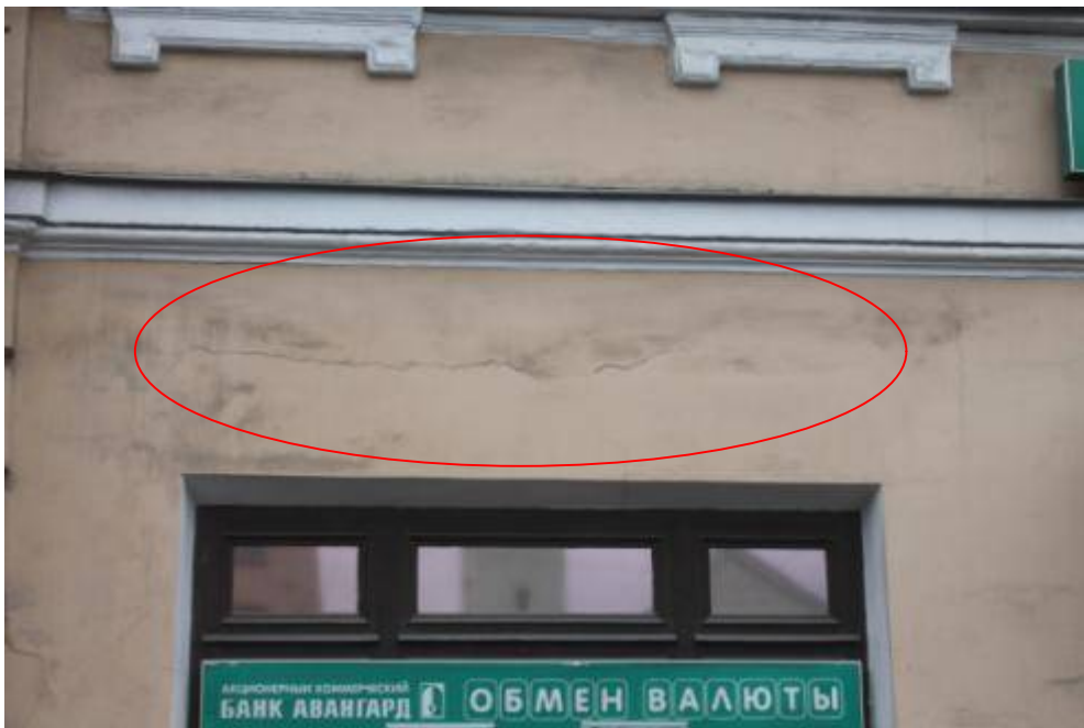
Фото 4. Система волосяных трещин в штукатурном слое, фасад по оси «Е».
