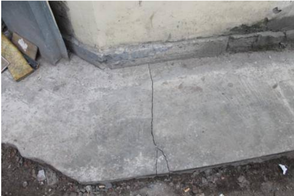
Фото 11. Разрушение отмостки, фасад по оси "А".
