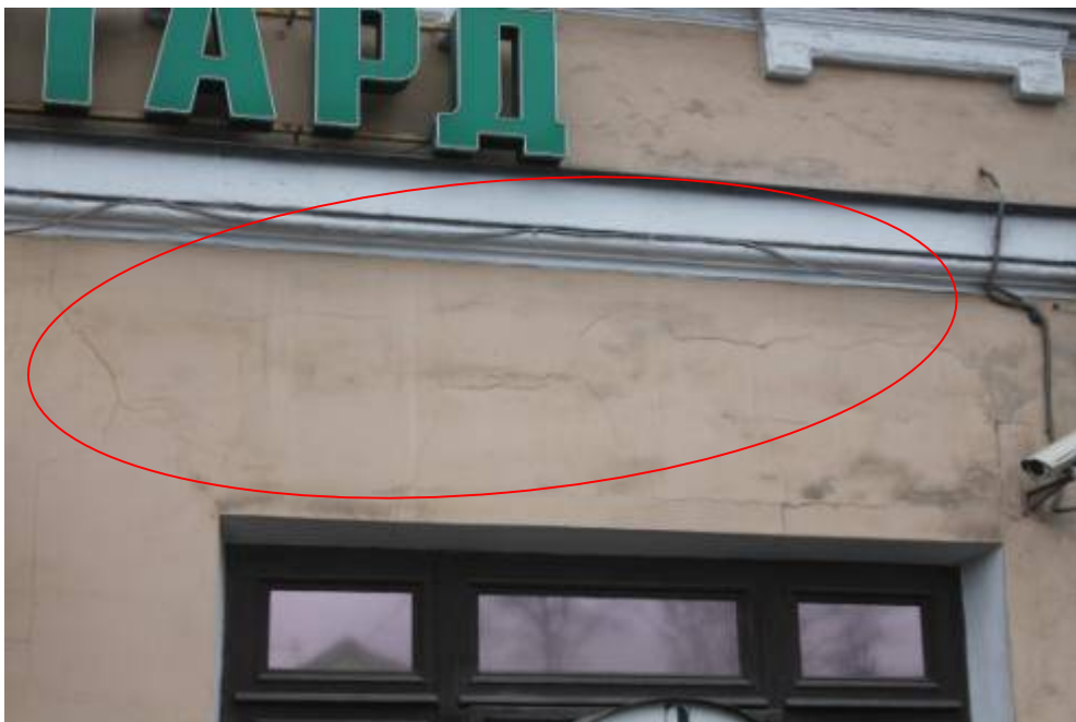
Фото 2. Система волосяных трещин в штукатурном слое, фасад по оси «Е».
