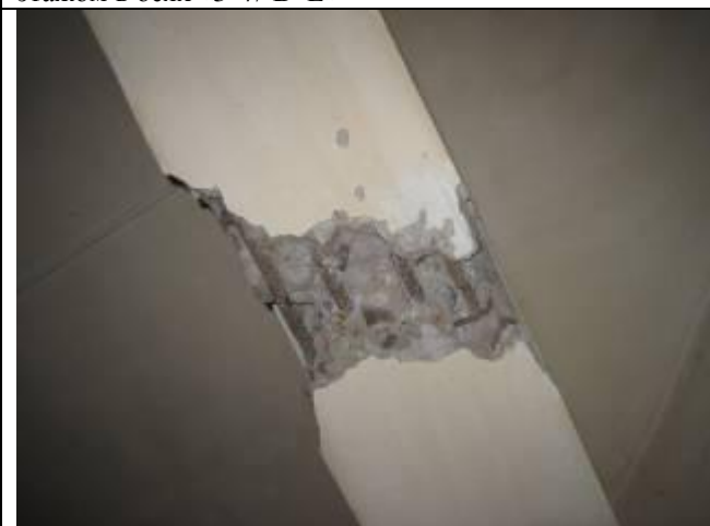
Фото 2.27. Главная балка ж/б перекрытия над пятым этажом в осях «3-8/А-В»
