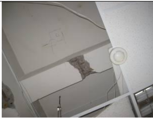
Фото 2.30. Второстепенная балка ж/б перекрытия над пятым этажом в осях «8-9/А-В»
