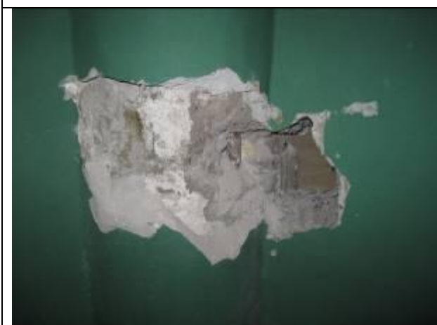
Фото 1.11. Колонна по оси «5/В», «6/Б» пятый этаж
