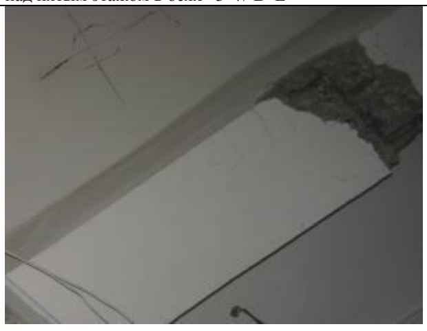
Фото 2.28. Второстепенная балка ж/б перекрытия над пятым этажом в осях «3-8/А-В»
